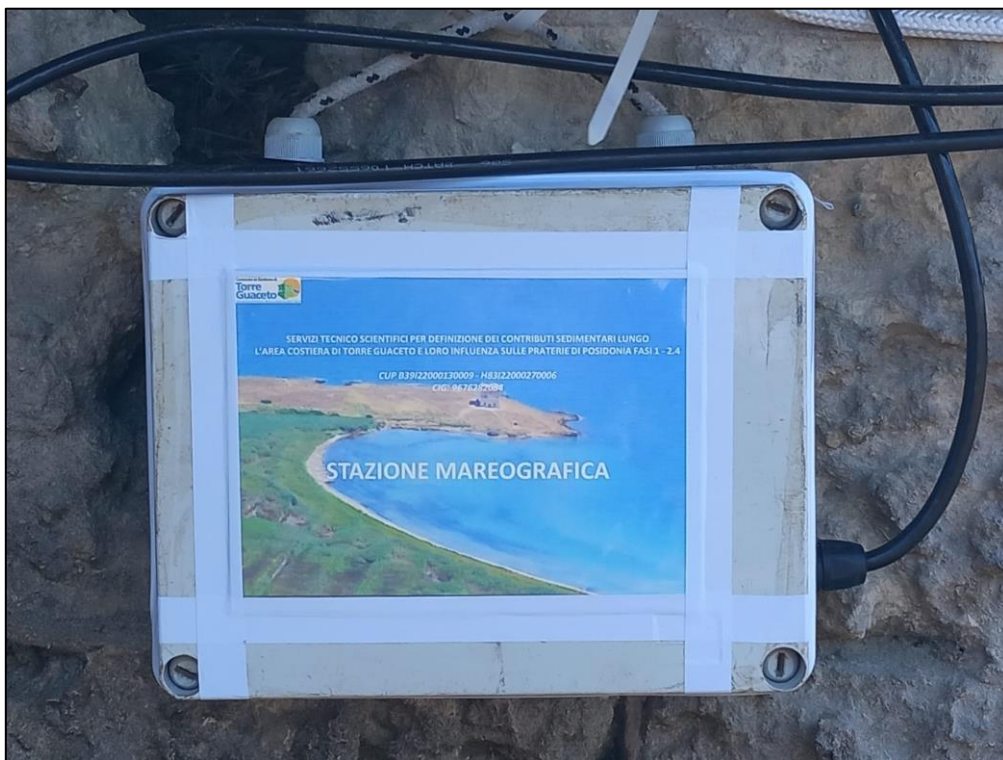
Figura 16 – Particolare della cassetta stagna in cui è stata installata l’unità di superficie
